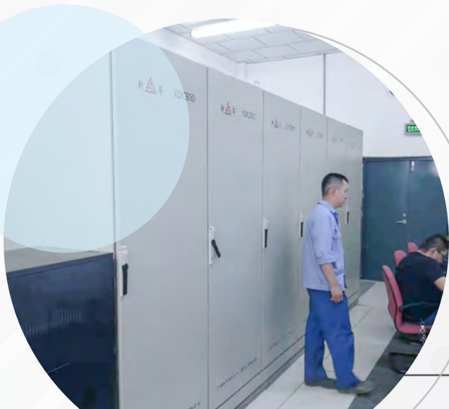
电子设备间一角
